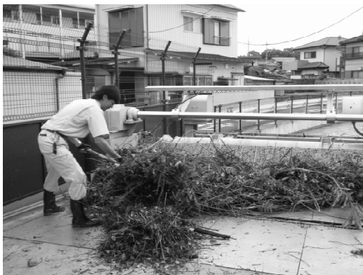
除塵機のゴミの状況
