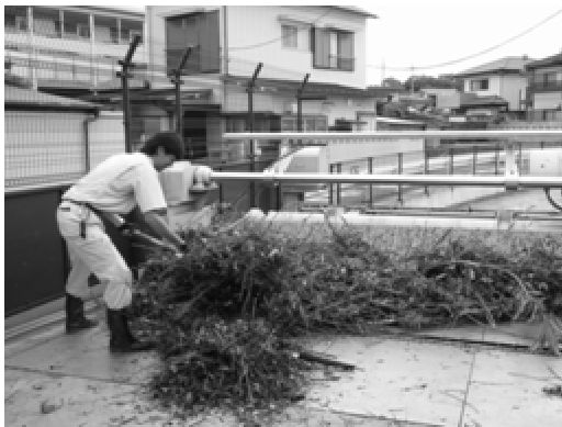
除塵機のゴミの状況
